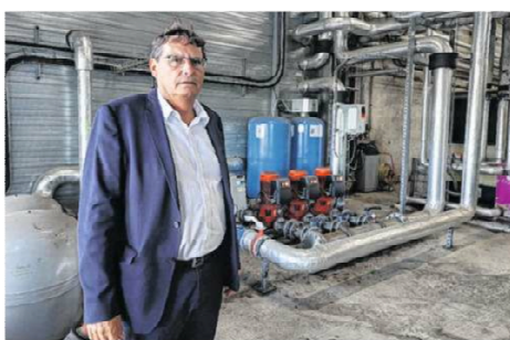
Alain Verna chez Toshiba, a investi dans un récupérateur de chaleur pour économiser 70 % de sa consommation de gaz.
